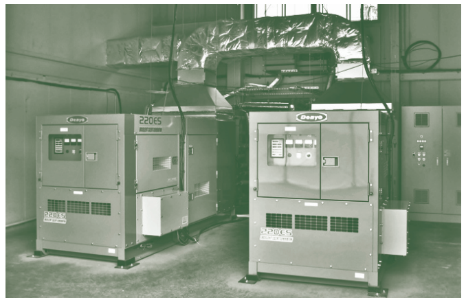
花見台フード・グリーン発電所 (100KW×24h×365日)
